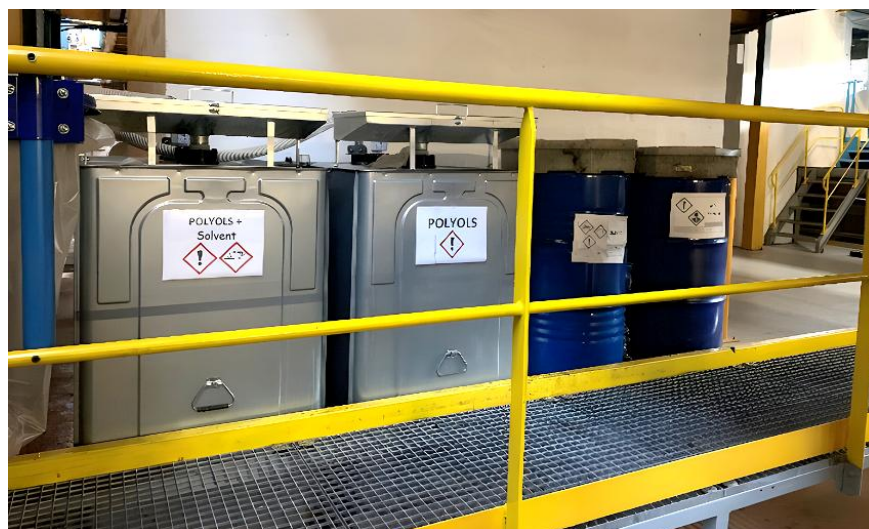
Figure : 17 Infrastructure de collecte des déchets dédiée. Dans cette installation, certains flux de déchets liquides sont collectés dans des conteneurs fixes et, une fois un certain niveau atteint, sont pompés dans des GRV dédiés qui sont ensuite acheminés vers un site de stockage des déchets dédié.
